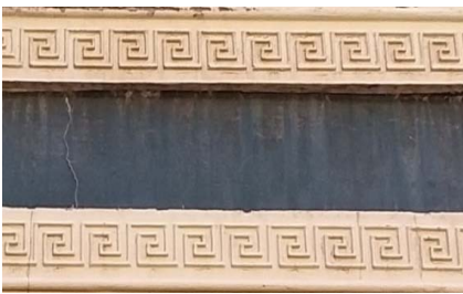
شكل 34. مفروكة تعلو كل فتحات الأبواب والنوافذ بالطابق الأرضي لمدرسة سعيد الأول، (تصوير الباحث).
